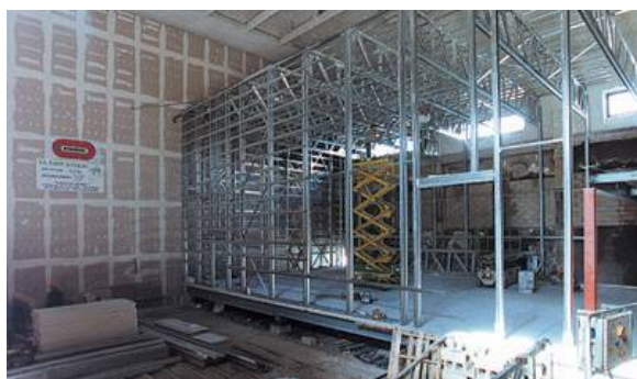
Figure 9 : Studio cinéma salle THX – Paris Structure autoportante avec un D_{nT,A} de 80 dB
