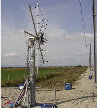
FIG. 1: Exemple d'antenne composée de deux étoiles encastrées.
