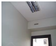
Figure 8 : Réseau Soufflage longeant la façade en Soffit :
